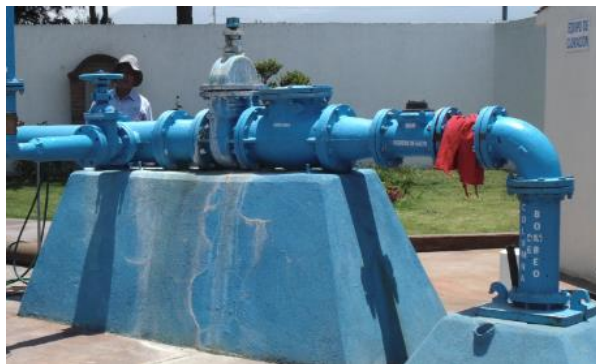
Pozo Nuevos Horizontes
